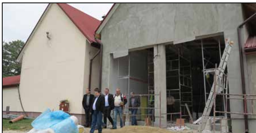
Tu rok 2014, ale kolejny etap rozbudowy i modernizacji oczyszczalni trwa. Tu trafiają ścieki z okolicznych Wsi, m.in. z Karolewa, Nowej Wsi.
