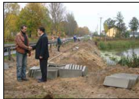
Przy DK 62 brakuje jeszcze kilku odcinków chodnika. Tu rok 2005 i budowa brakującego odcinka w Woli Brwileńskiej.
